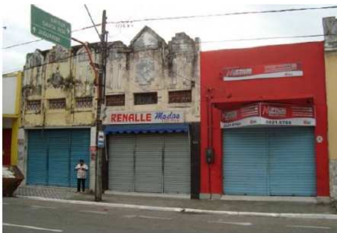
Figura 100: Constata-se o estado atual da edificação onde um dos prédios (o da direita) perdeu características do projeto original e os outros dois estão em péssimo estado de conservação. Foto: Fernanda Farias (Setembro, 2009).
