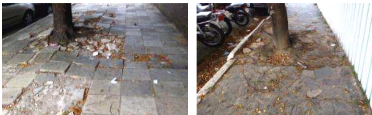
FIGURA 82. Calçadas em estado precário de conservação (quarteirões B e C, respectivamente). FONTE: SILVEIRA (2011).
