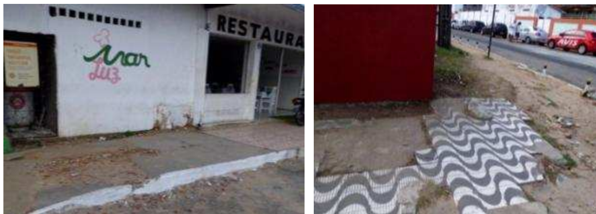
FIGURA 80. Passeios em estado precário de conservação (quarteirão A) FONTE: SILVEIRA (2011).
