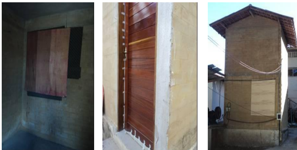
Figura 36 – Detalhe das vedações nas esquadrias.
