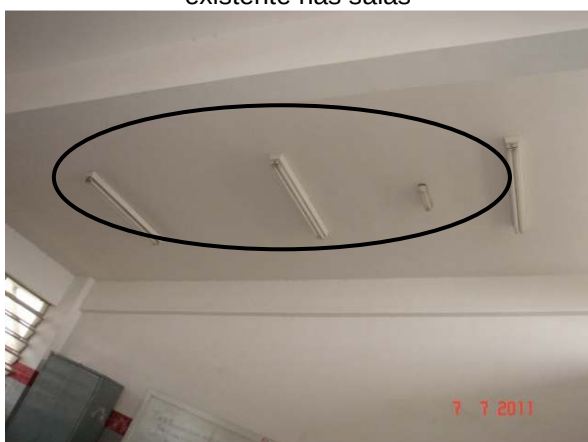
Fotografia 4.25 - Detalhe da iluminação artificial existente nas salas
