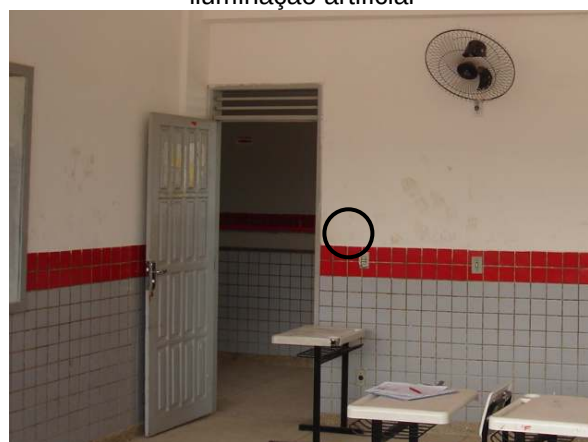
Fotografia 4.26 - Detalhe do acionamento da iluminação artificial
