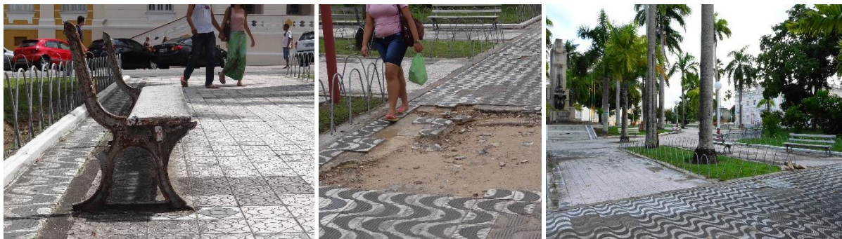
Figura 56, 57, 58: Banco e piso em péssimas condições na Praça João Pessoa. Troca do piso e bancos defeituosos na praça após reforma. Fonte: Site da Assembleia Legislativa da Paraíba. Acessado em 03.02.2014 < http://www.al.pb.gov.br/10926/ivaldo-moraes-apelo-reforma-praca-joao.html >. E Marcela Dimenstein, Jun.13
