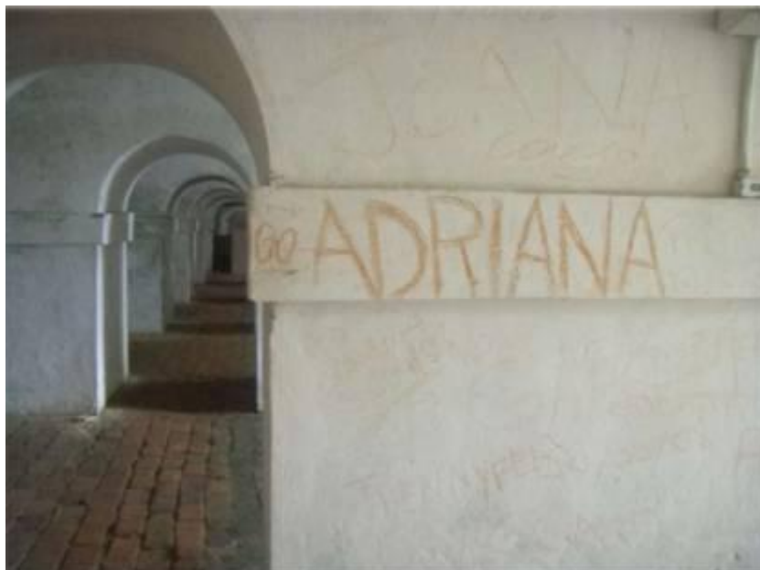
Imagem 34: Pichação na estrutura de um dos edifícios interno da fortaleza (Casamata Leste do MFSJM). Fotografia Kelly Aparecida M. Chaves 2010.
