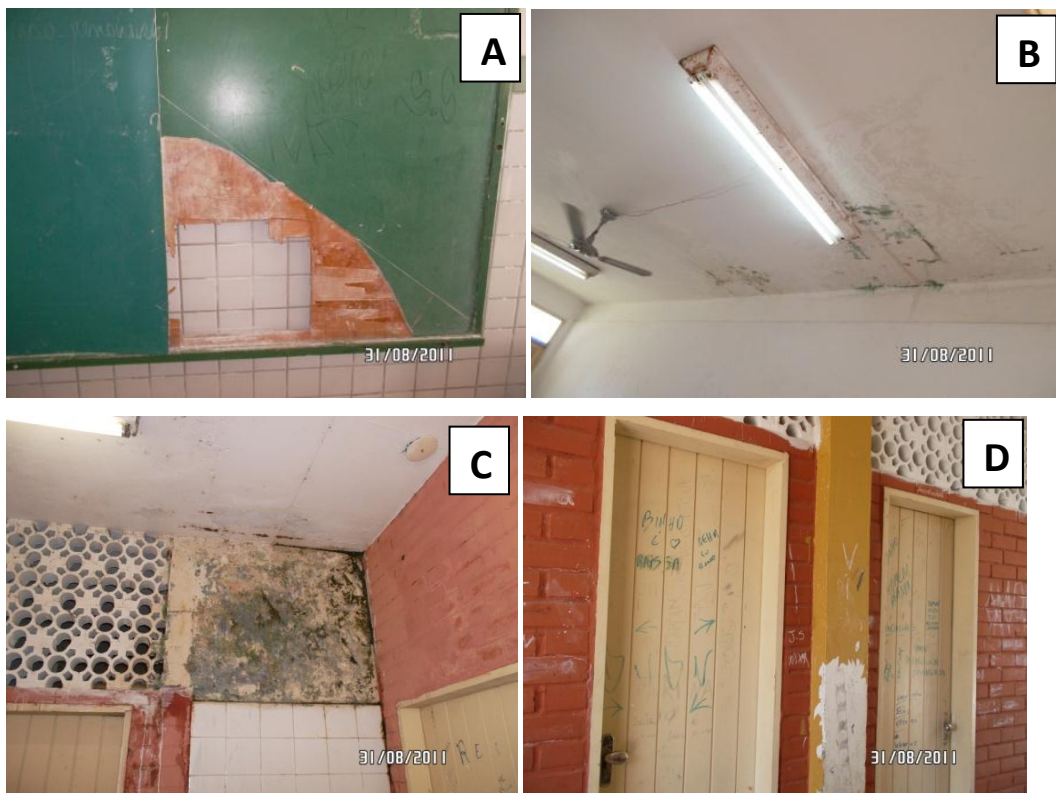
Figura 8- Dependências em mal estado: (A e B) salas de aula, (C, D, E ,F) banheiros e (G) bebedouros da EEEFM Dona Alice Carneiro.
