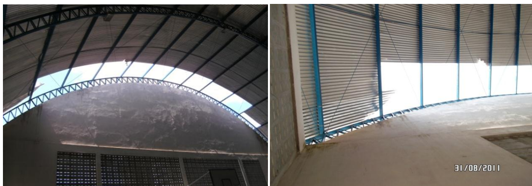
Figura 5 – Telhado solto da quadra Poliesportiva da EEEFM Dona Alice Carneiro, localizada na cidade de João Pessoa- PB
