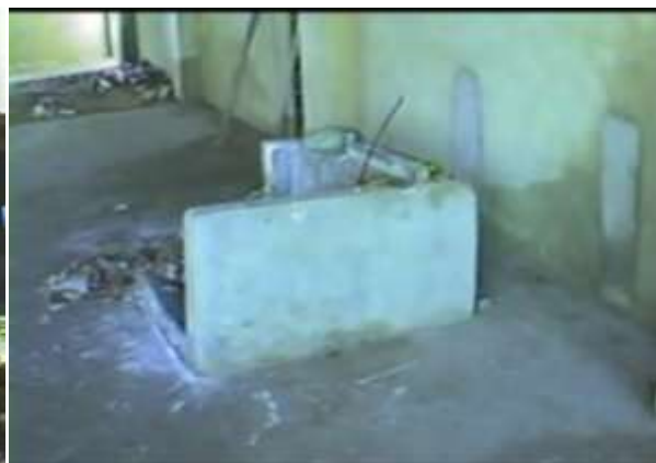
FIGURA 07 - LOCAL ONDE FICAVA O MOTOR
