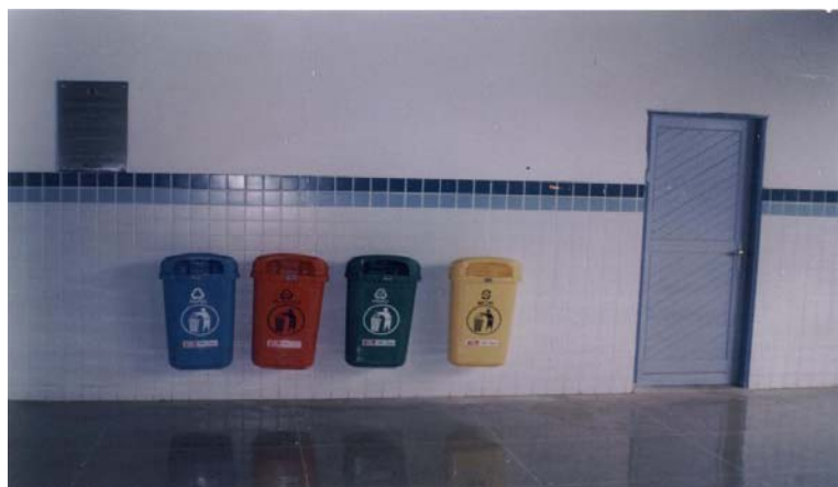
Figura 64 – Coletores para coleta seletiva, instalados no interior da Escola Municipal Antônio Santos Coelho Neto
