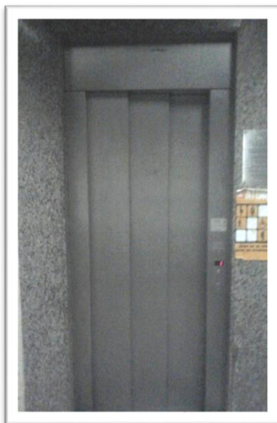
Foto 7 - Elevador adaptado para pessoas com deficiência física ou mobilidade reduzida
