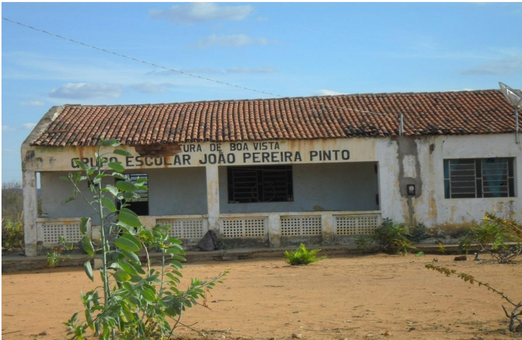
Figura 6 - Grupo Escolar José Pereira Pinto em estágio de deterioração
