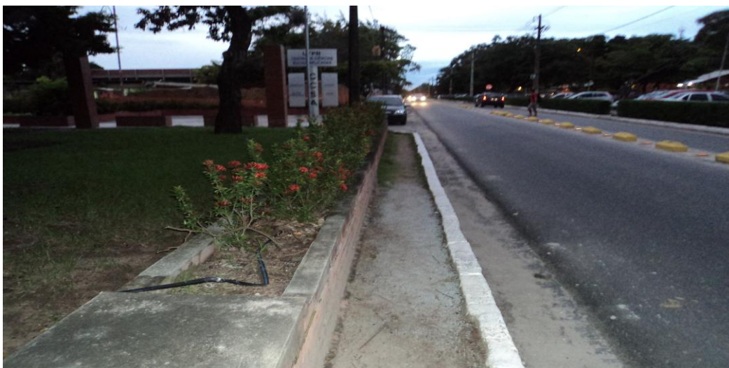
Foto 4 Calçadas estreitas, com degraus e superfícies irregulares
