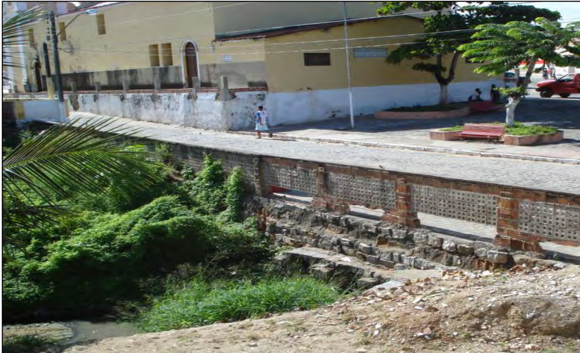
Foto 02 – Esgoto público direcionado ao Rio Curimataú. Setembro de 2008.
