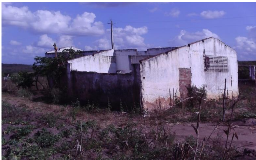
Figura 04- Galpão em ruínas onde funcionou a Escola Tiradentes, no período inicial do acampamento. Fonte: Arquivo do pesquisador, 2009.
