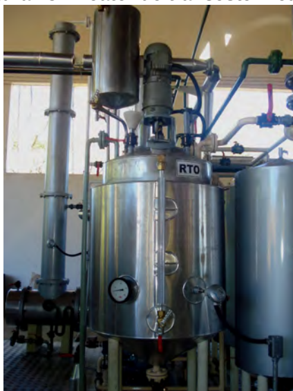
Figura 13 - Reator de transesterificação
