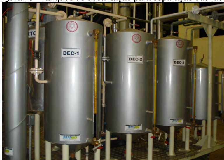
Figura 15 - Tanques de decantação para separação das fases
