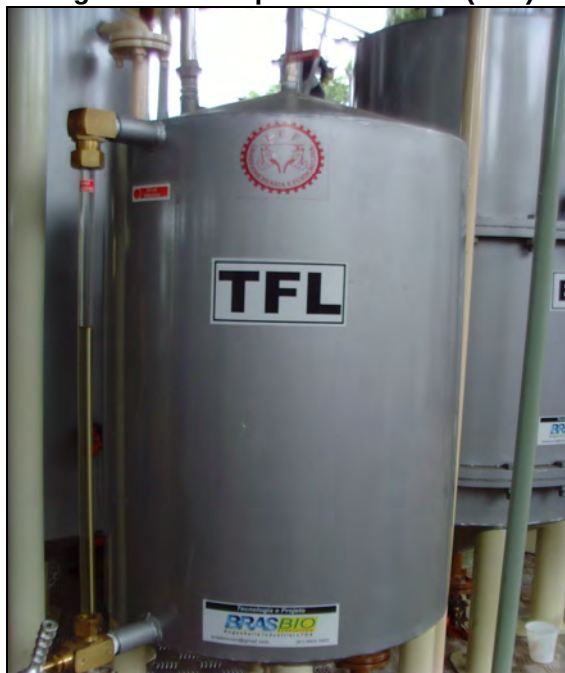
Figura 16 - Tanque de fase leve (TFL)
