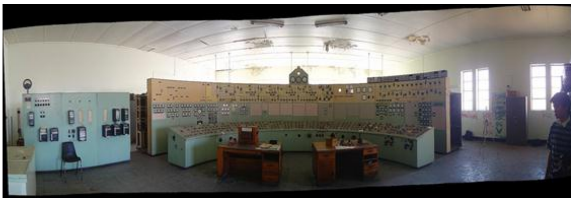
Figura 17 - Sala de Operação e Controle de um Sistema de Energia Elétrica.
