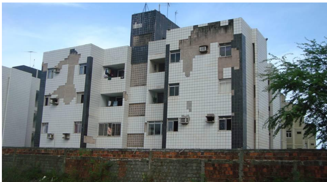
Figura 2.5: Fachada oeste de Prédio no bairro do Bessa com grande quantidade de descolamento das placas cerâmicas.
