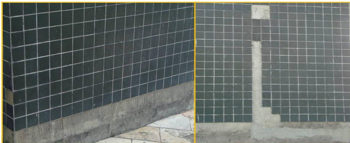
Figura 4.11: Descolamento de revestimento cerâmico em função da expansão por umidade devido ao gradiente de temperatura.
