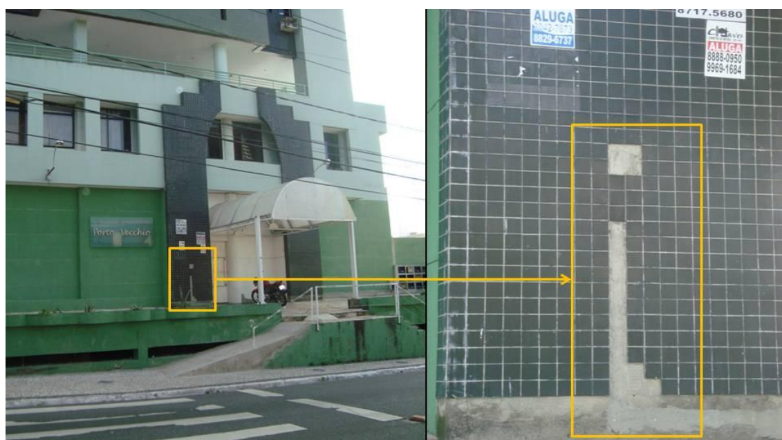
Figura 2.6: Fachada de Prédio no Miramar e detalhe do descolamento de cerâmicas na fachada oeste.
