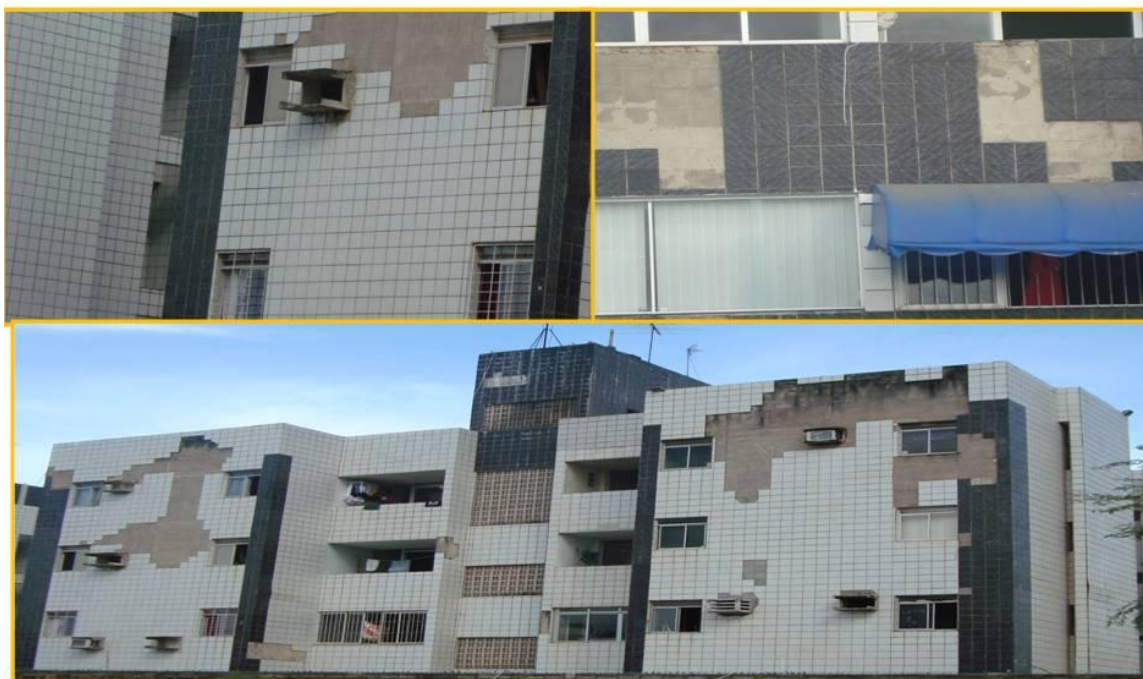
Figura 4.2: Queda de revestimento da Fachada do Ed. Residencial 01 até a degradação total devido a expansão por umidade e gradiente térmico.
