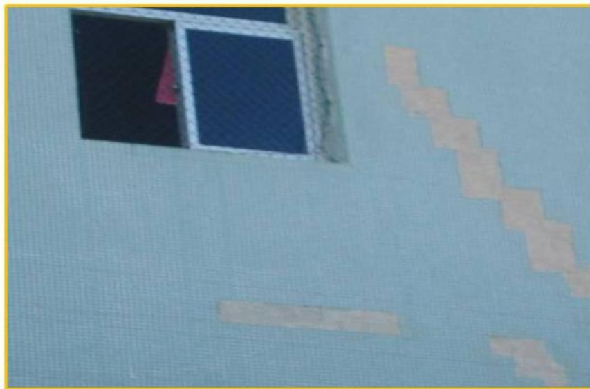
Figura 4.10: Queda do revestimento cerâmico devido a movimentação estrutural.
