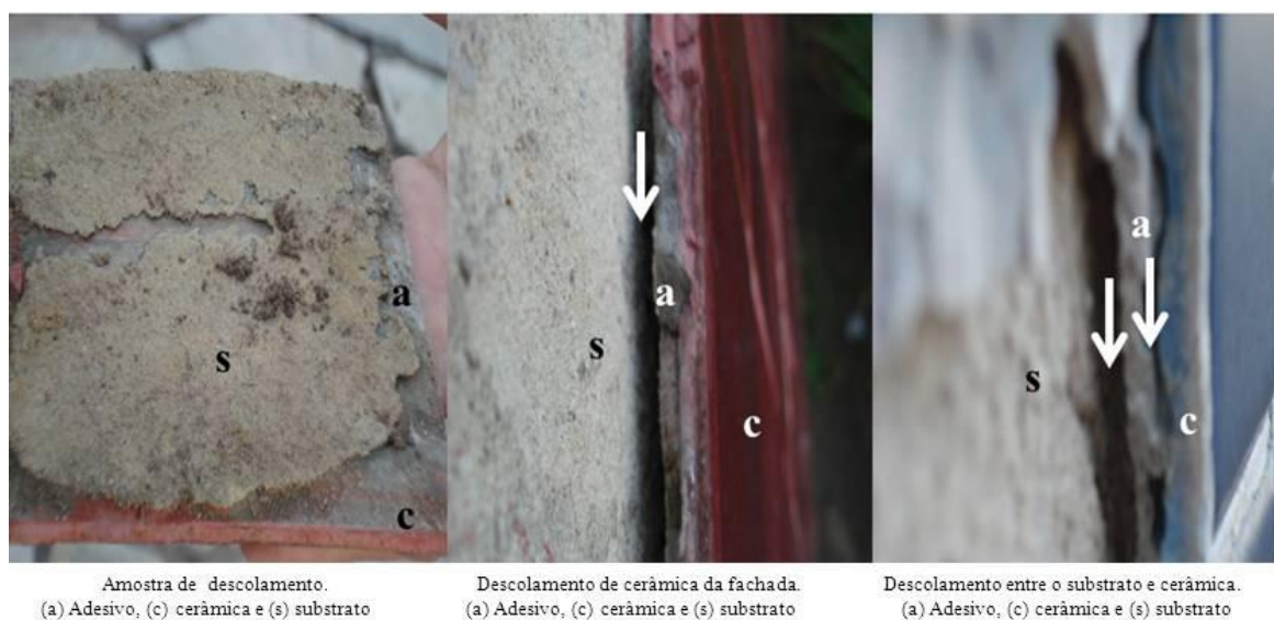
Figura 2.7: Vários tipos de descolamentos de revestimentos cerâmicos em edifícios localizados na cidade de João Pessoa, Paraíba - Brasil
