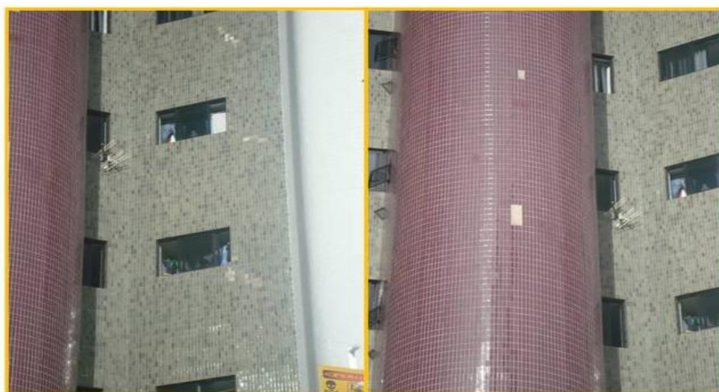
Figura 4.5: Degradação do revestimento em pastilhas do Ed. Res. 02 (edificação de Padrão Alto)
