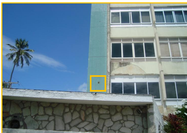
Figura 4.16: Fachada do Edifício com Detalhe para a queda do revestimento.
