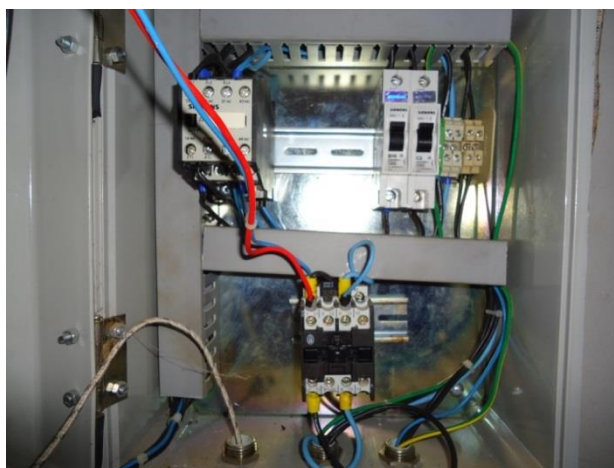
Figura 3.5 – Sistema de Acionamento.
