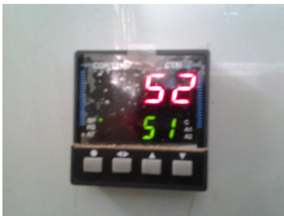
Figura 3.3 – Controlador de Temperatura.
