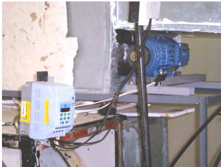
Figura 3.17. Ventilador principal e inversor de frequência.
