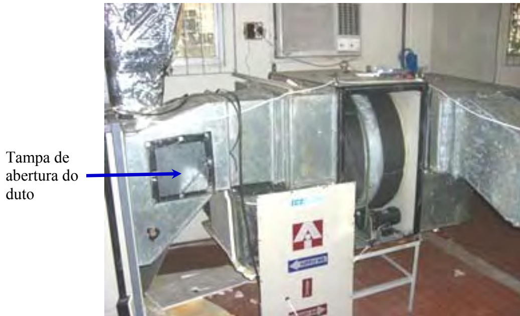
Figura 6.10. Identificação da abertura do duto antes do segundo rotor dessecante.
