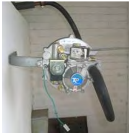
Figura 3.15. Válvula redutora de pressão.
