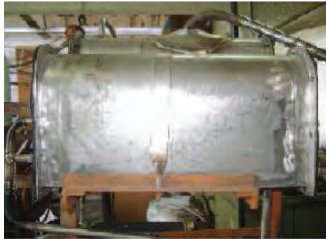
(a) Vista frontal do conjunto gerador II / condensador
