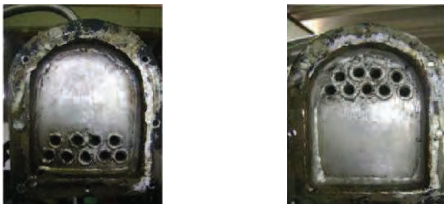
(b) Vistas Laterais do Gerador de Vapor I
