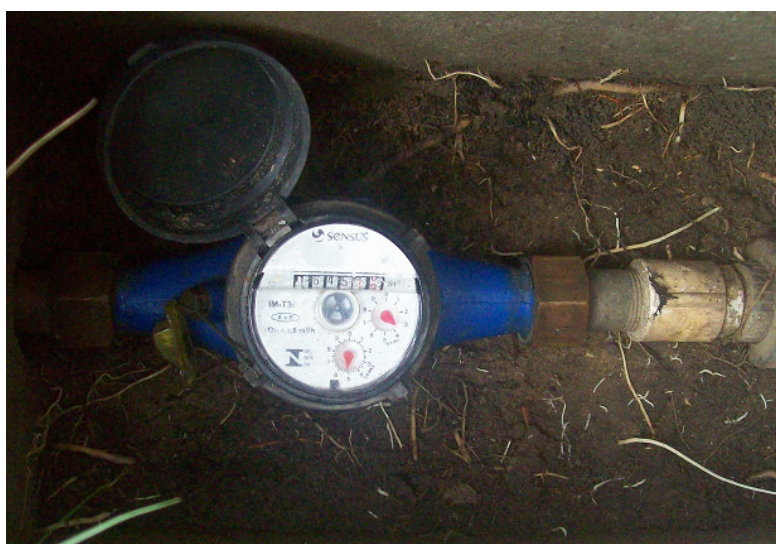
Figura 13: Hidrômetro da residência A.
