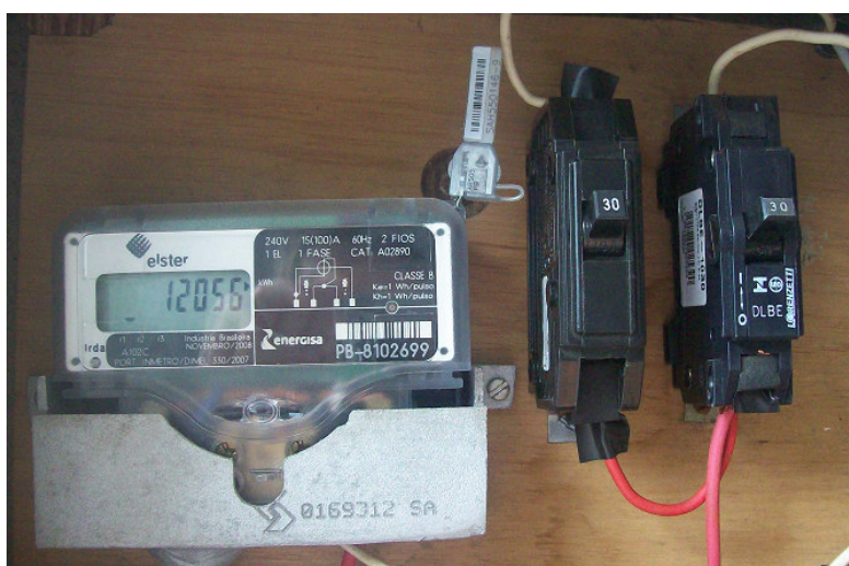
Figura 14: Medidor de energia da residência A.
