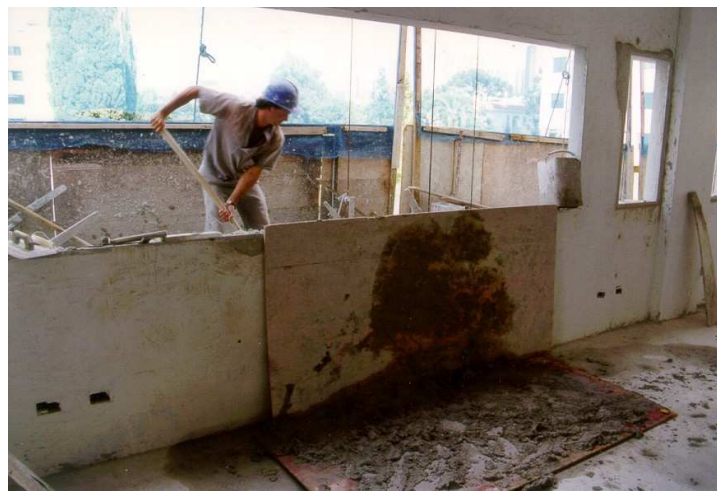
Figura 11 - Perdas de concreto devido ao transporte inadequado.
