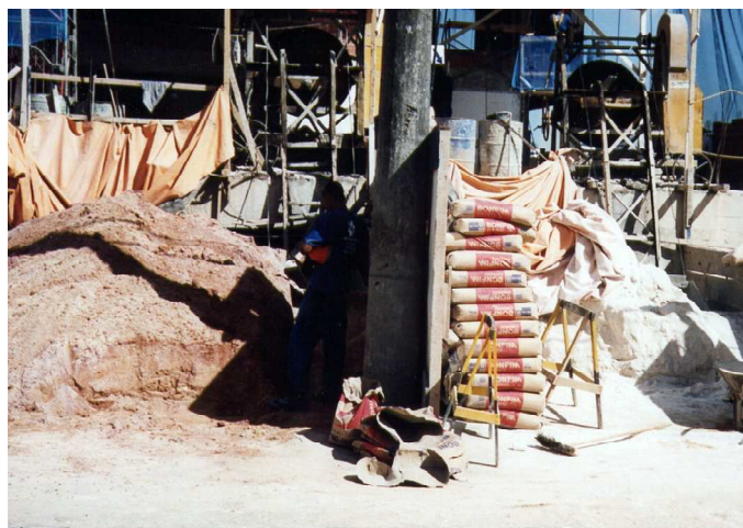
Figura 04 - Armazenamento inadequado de materiais
