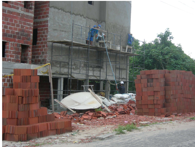
Figura 09 - Armazenamento inadequado de blocos cerâmicos.
