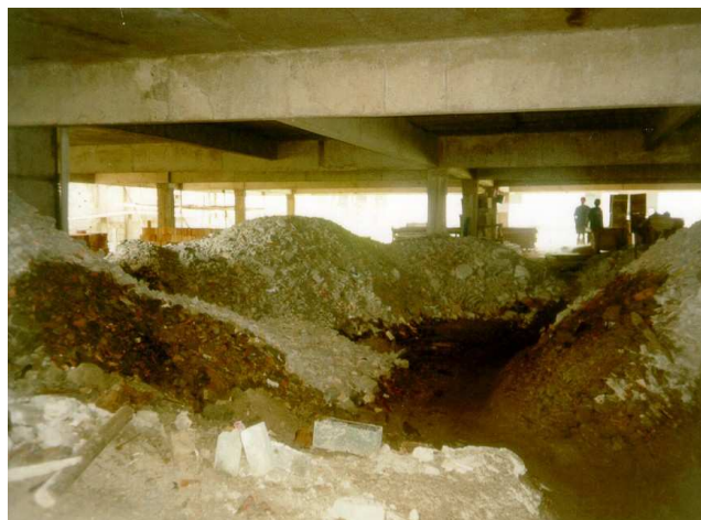
Figura 01 - Volume intenso de entulho em obra
