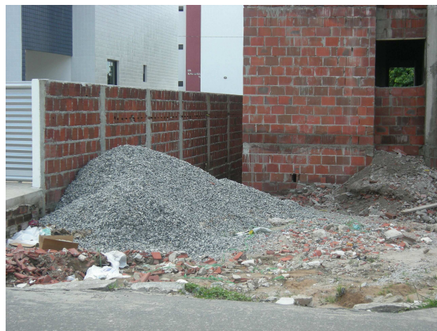
Figura 07 – Armazenamento inadequado em área externa
