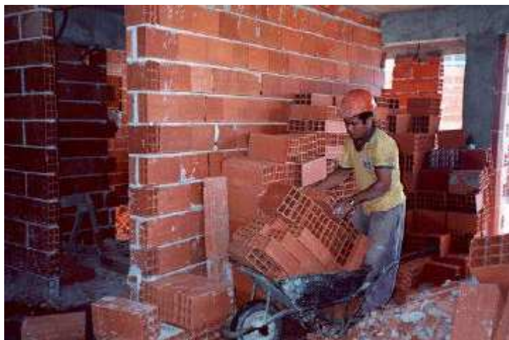
Figura 16 - Exemplo de transporte inadequado de blocos
