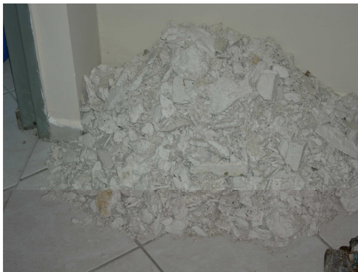
Figura 15 - Perdas de gesso devido ao revestimento
