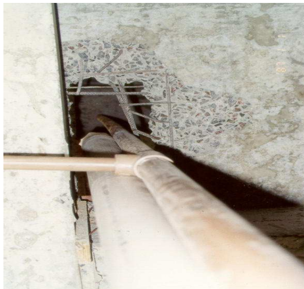
Figura 03 - Passagem improvisada da instalação hidráulica
