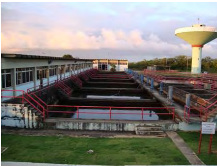
Figura 11 - Filtros da ETA.
