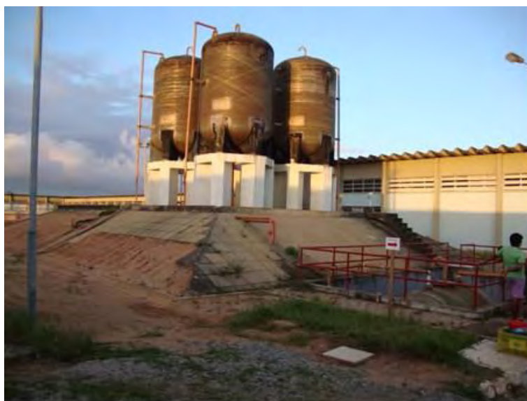
Figura 15 - Tanques de Produtos Químicos.
