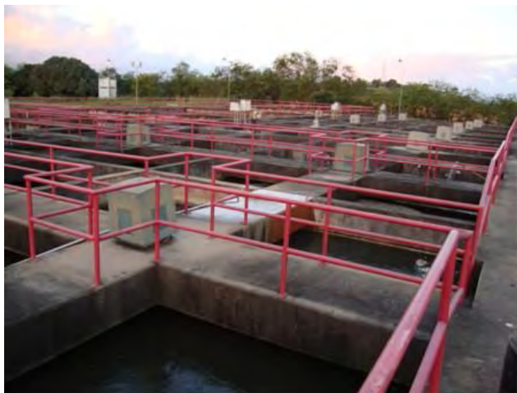
Figura 9 - Flocculador atual da ETA.
