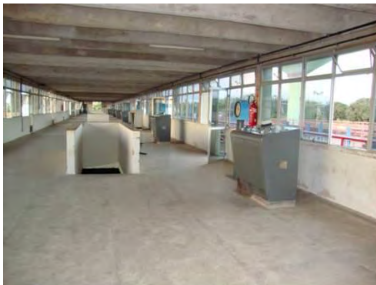
Figura 12 - Galeria de Comando.
