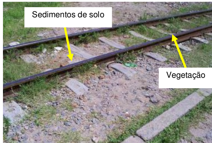
Figura IV.15 – Exemplo de contaminação do lastro da ferrovia.
