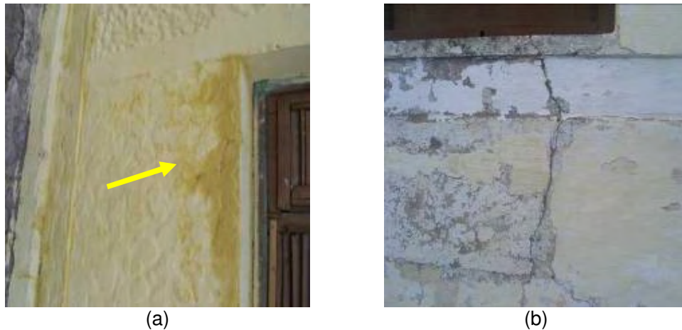
Figura IV.10 – Outras patologias encontradas: (a)umidade; (b) descascamento de pinturas.
