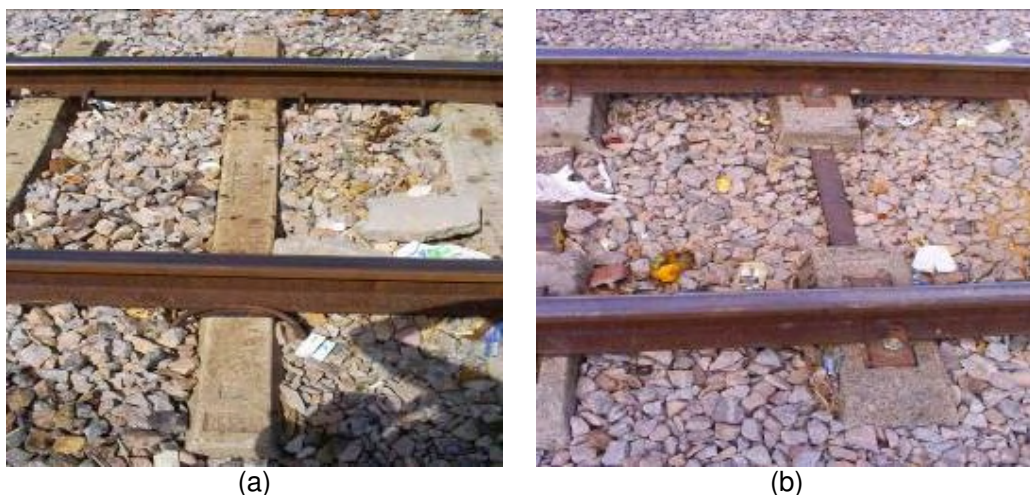
Figura IV.13 – Detalhe dos trilhos. (a) TR-45 sobre dormentes monoblocos e fixação elástica (grampo) tipo FIST; (b) TR-32 sobre dormentes biblocos e fixação (parafusada) tipo RN.
