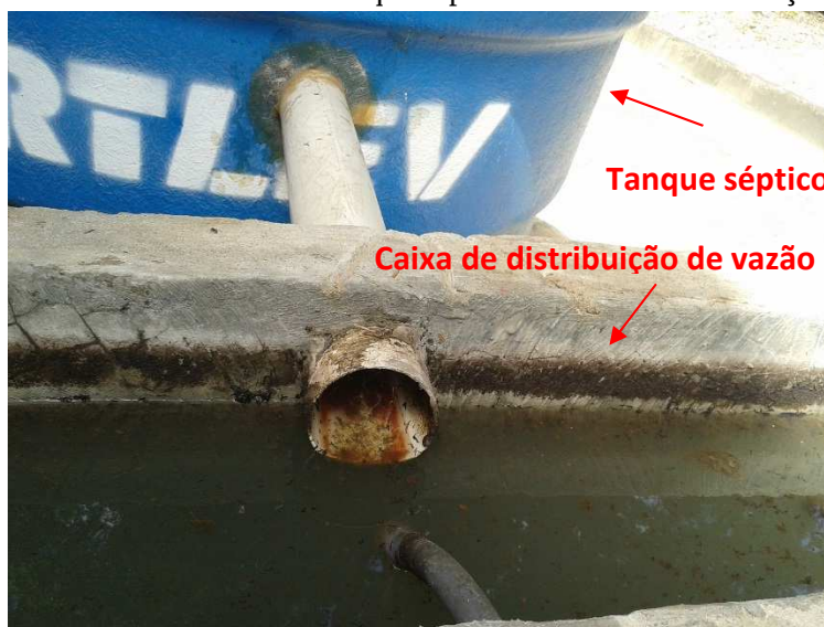
Figura 32: Entrada do efluente do tanque séptico na caixa de distribuição de vazão.
