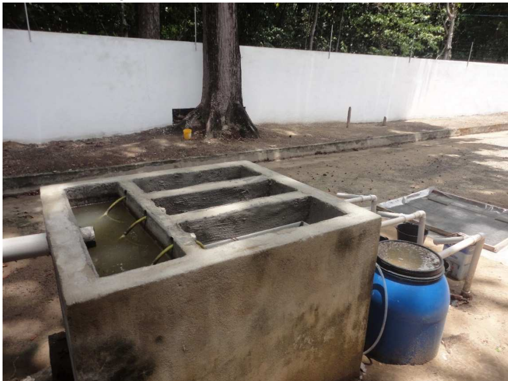
Figura 19: Vista da caixa de distribuição de vazão.
