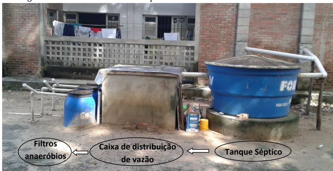
Figura 15: Sistema de tratamento implantado na Residência Universitária da UFPB.
