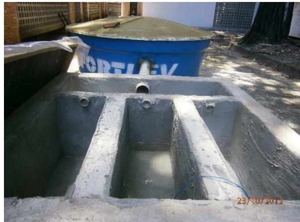
Figura 18: Vista dos três compartimentos da caixa de distribuição de vazão que antecedem os três filtros.
