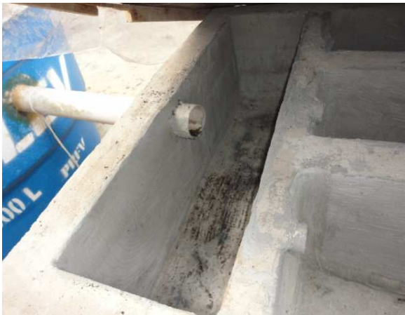
Figura 17: Entrada do efluente do tanque séptico na caixa de distribuição de vazão.
