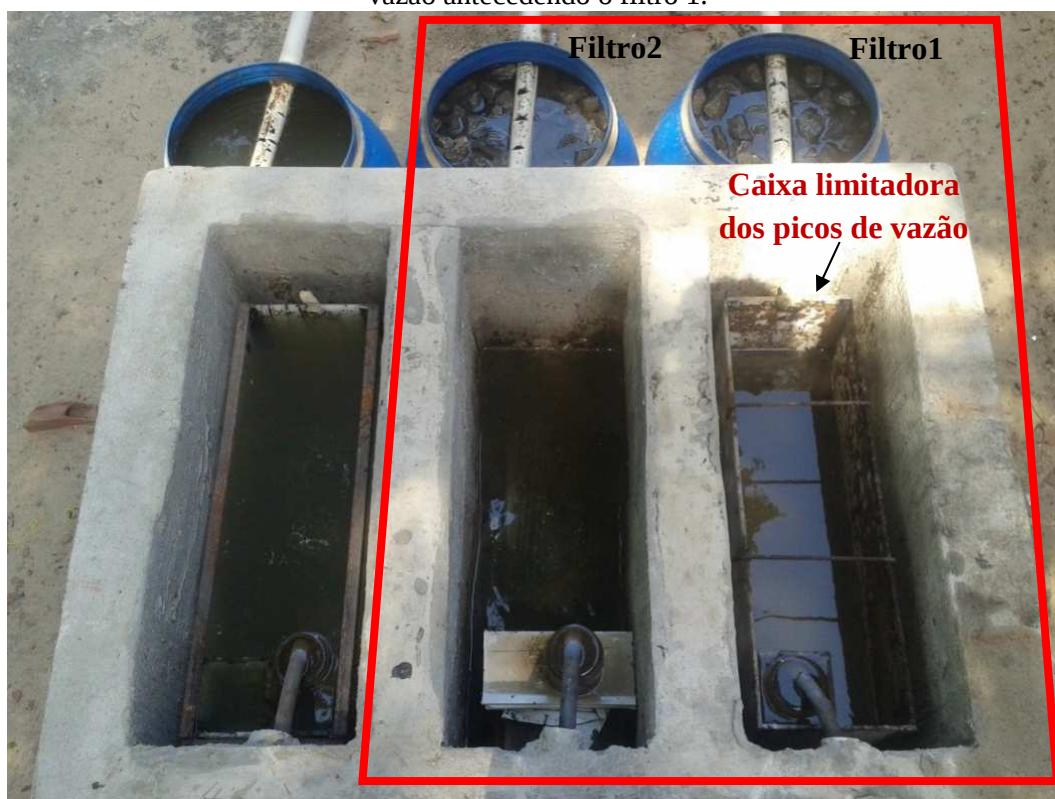
Figura 16: Vista interna da caixa de distribuição de vazão – presença de caixas limitadoras dos picos vazão antecedendo o filtro 1.
