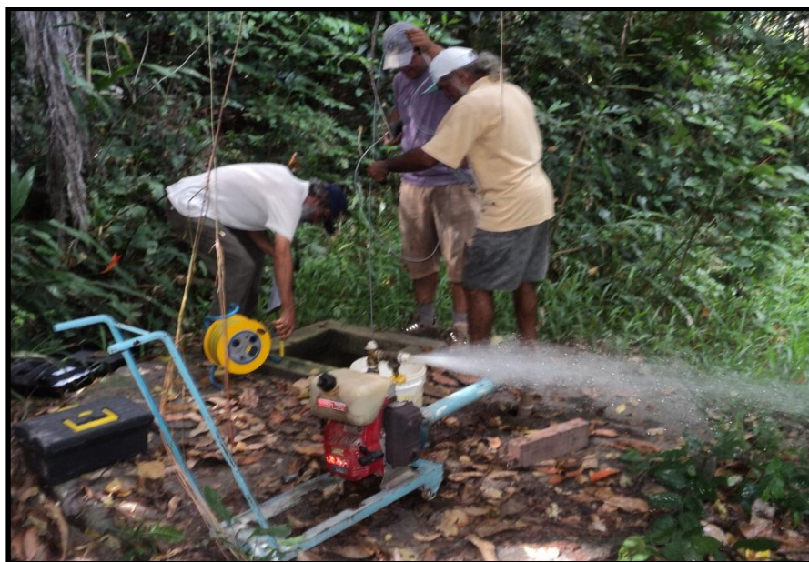
Figura 14 - Bomba Hidráulica – procedimento de nivelamento de água
