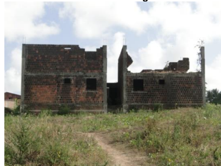
Figura 5.15 - Prédio residencial (construção abandonada). Rua Luiz Teotônio de Souza. João Pessoa-PB.
