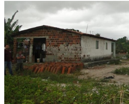
Figura 5.40 - Residência construída na margem do rio Cuiá, João Pessoa-PB.
