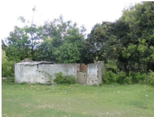
Figura 1.9 - Construção em ruínas na APP do rio Cuiá. Rua Cecília Furtado da Silva, Gramame, João Pessoa-PB.
