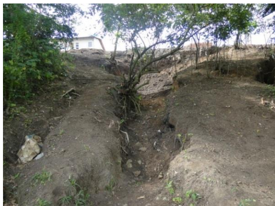
Figura103 - Voçoroca na margem direita do rio Cuiá. Comunidade Maria de Nazaré, João Pessoa-PB. Fonte: Anjos, 2013.
