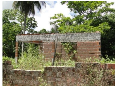
Figura 3.37 - Construção de residência abandonada. Rua Sebastião Renato de Melo. João Pessoa-PB.
