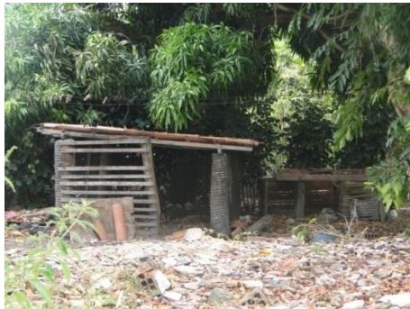
Figura 5.38 - Galinheiro construído em APP, nos fundos da residência (Figura 5.37).
