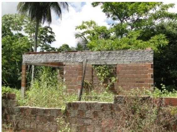
Figura 57 - Construção de residência abandonada. Comunidade N. Senhora das Neves, João Pessoa-PB. Fonte: Anjos, 2013.
