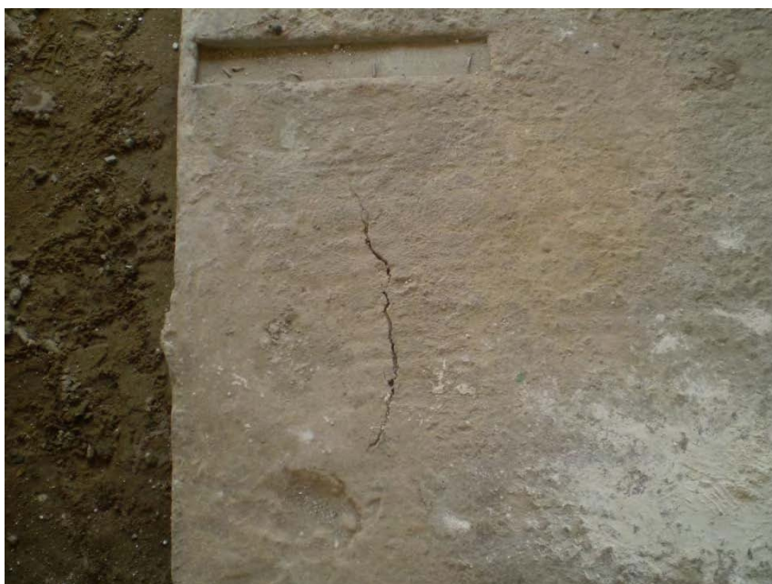
Figura 4.20 – Fissura no bloco 9.
