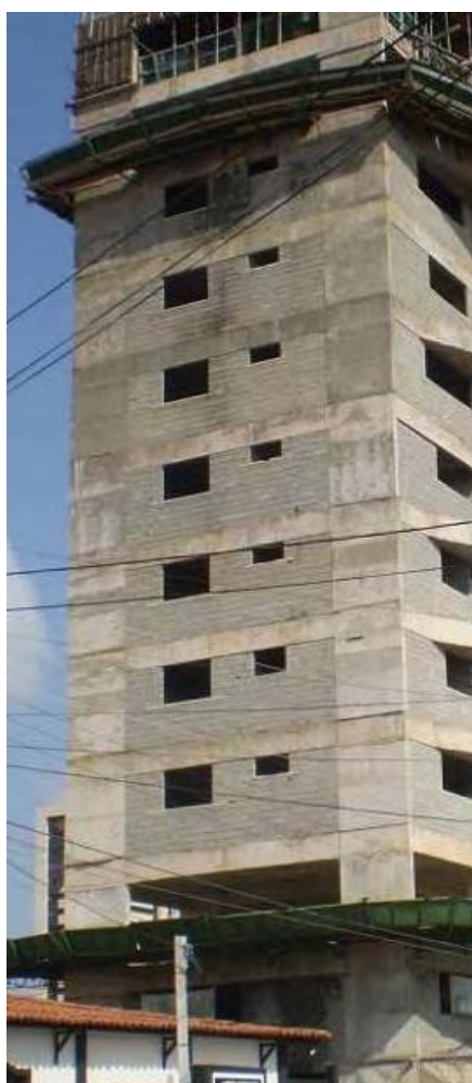
Figura 4.1 – Obra interrompida no 13ª Pav.
