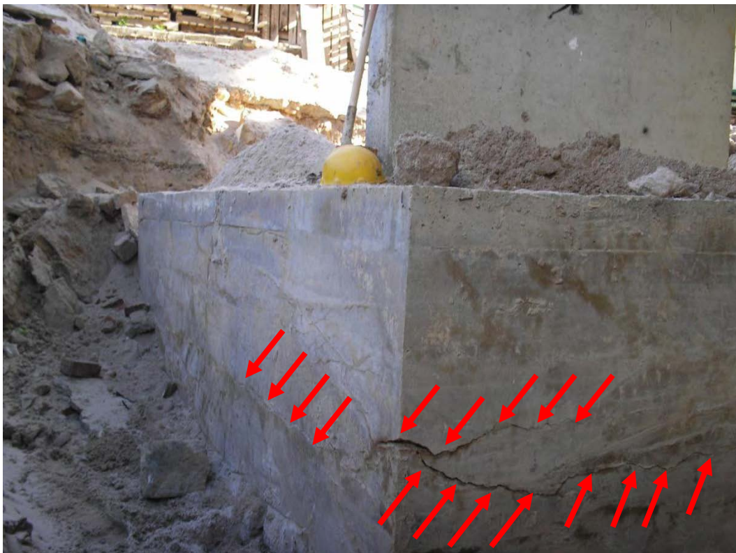
Figura 4.7 – Fissura horizontal em outra face lateral do bloco 7.
