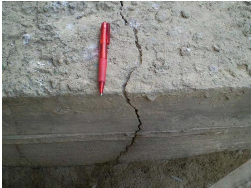
Figura 4.15 – Fissura de grande abertura no bloco 6.
