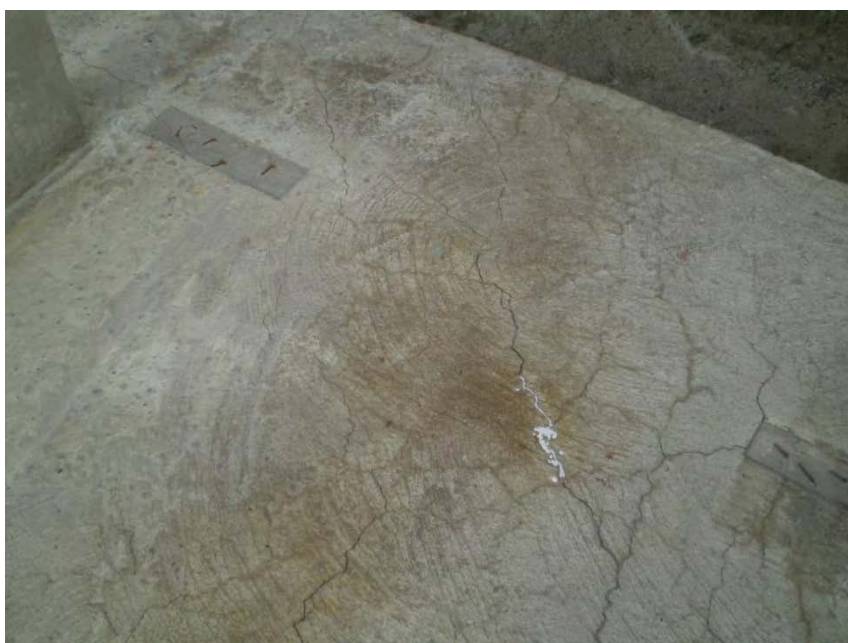
Figura 4.21 – Fissuração intensa na superfície do bloco 10.
