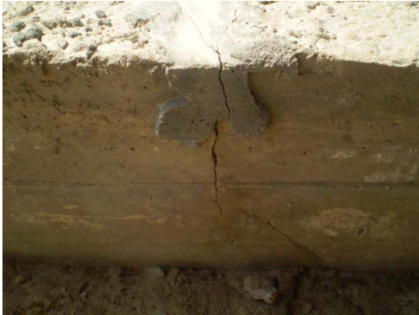
Figura 4.22 – Fissuração ativa em todo o bloco 7.
