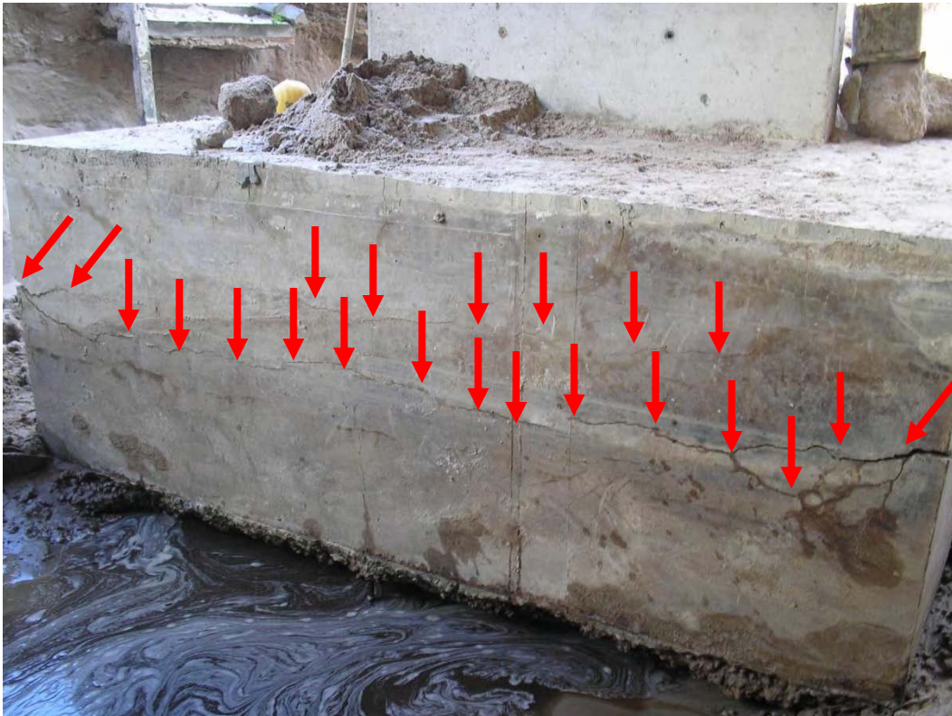
Figura 4.6 – Fissura horizontal na face lateral do bloco 7.
