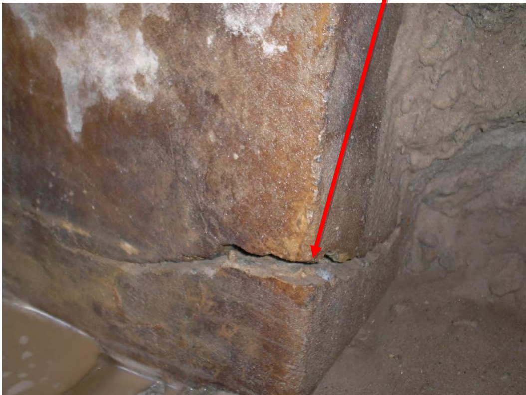
Figura 4.9 – Detalhe da trinca em uma das arestas do bloco 7.
