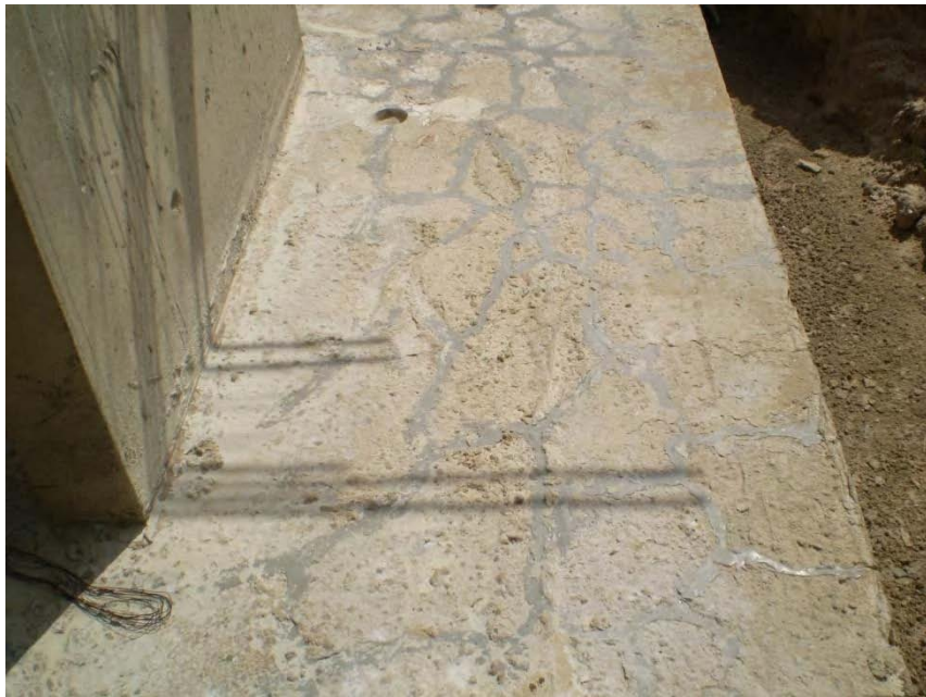
Figura 4.23 – Fissuras mapeadas no bloco 7.
