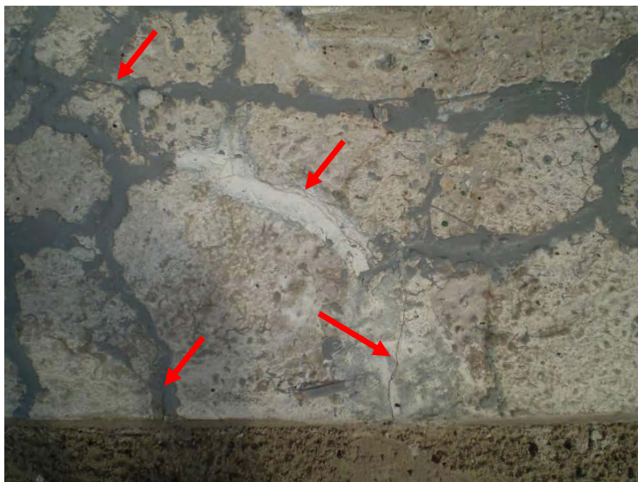
Figura 4.4 – Fissuras tratadas com epóxi na superfície do bloco, ativas, e, com aspecto de mapa.
