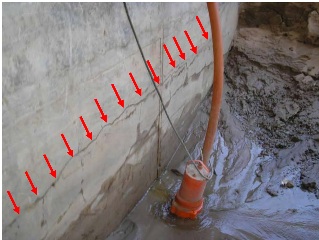
Figura 4.5 – Face lateral do bloco 7, fissurada horizontalmente.
