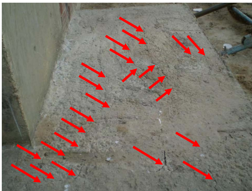
Figura 4.13 – Fissuras superficiais no bloco 6.
