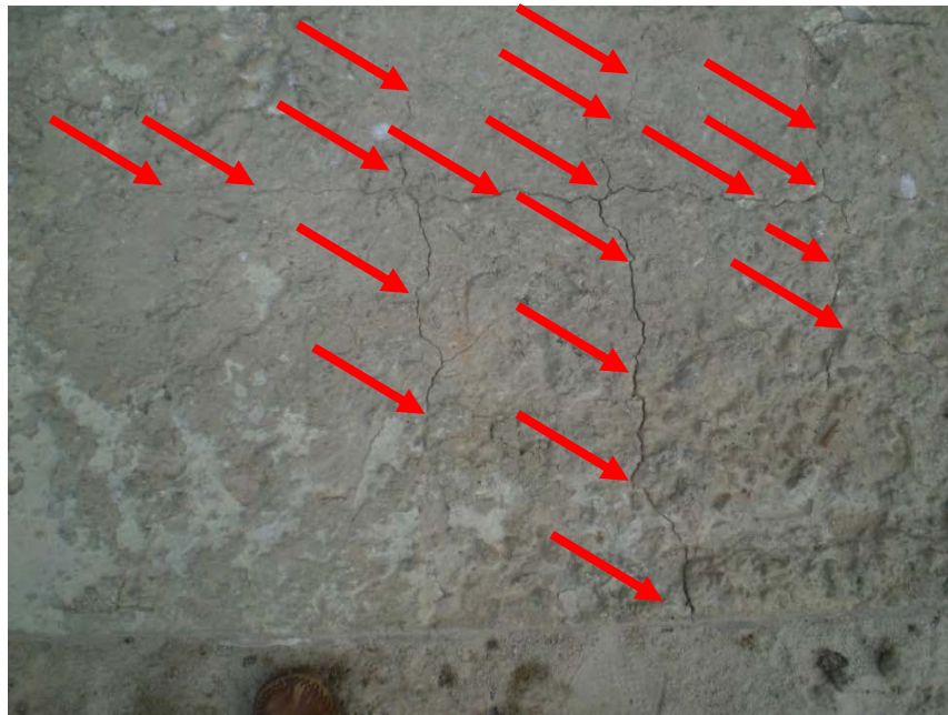
Figura 4.14 – Fissuras em forma de mapa no bloco 6.
