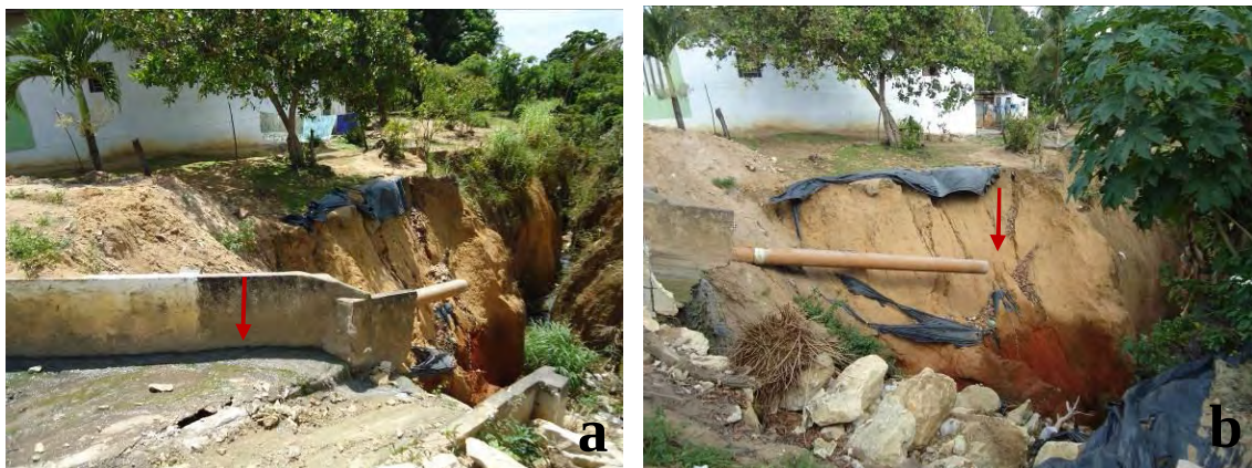
Foto 6.4a – Voçoroca no bairro Oiteiro em Alhandra PB. Notar despejo de esgoto (Foto: MARQUILENE SANTOS, 2011). Foto 6.4b – Escoamento de água devido às lavagens dos filtros da CAGEPA (Foto: MARQUILENE SANTOS)
