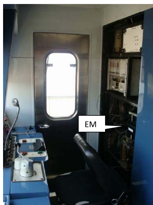
Figura 5.3: Local da instalação da EM dentro do TUE
