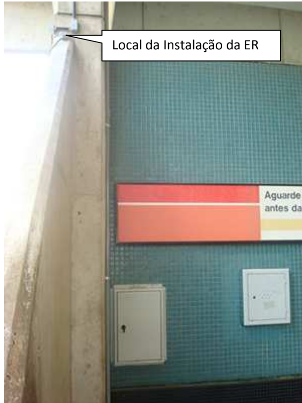
Figura 5.5: Local da instalação do roteador na cabeceira leste da Estação Werneck
