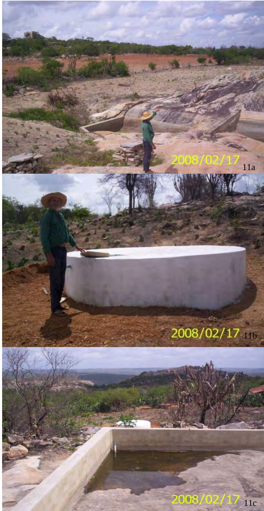
Fotos 11 (a,b e c) - Sistema de coleta e armazenamento de água da chuva sobre rochedo
