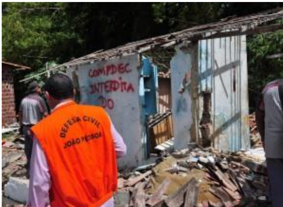
Figura 11: Habitação improvisada encontrada no bairro São José, João Pessoa-PB, e demolida por apresentar risco a população.
