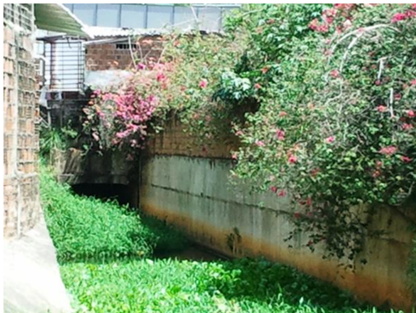
Figura 24- Final do Trecho 1 com canal retangular com construções no limite da calha principal, seção de montante da galeria retangular sob Av. Flávio Ribeiro Coutinho.
