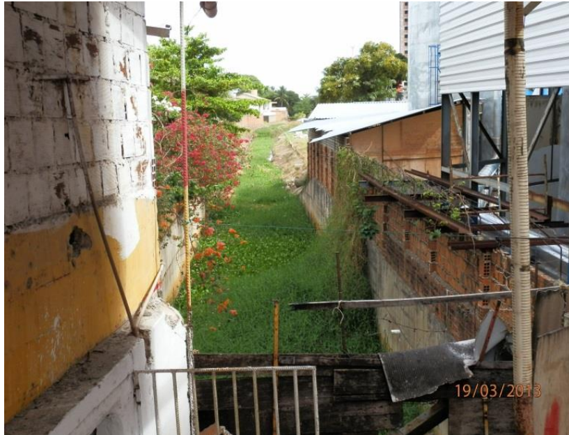
Figura 25 - Canal retangular, retificado. Muito lixo nas bordas do canal. Situada logo após a passagem da Av. Ribeiro Coutinho no sentido Sul-Norte.
