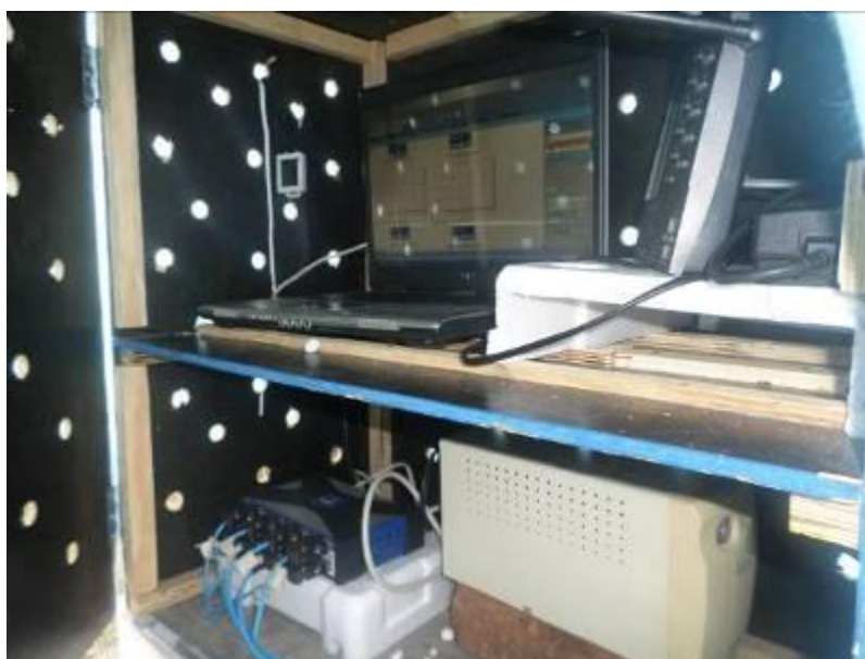
Figura 63: Imagem interna da caixa de madeira vazada, confeccionada para proteção dos equipamentos instalados no seu interior. Fonte: Acervo Próprio.
