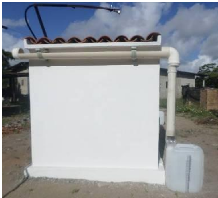
Figura 71: Sistema de coleta da água pluvial. Fonte: Acervo Próprio.
