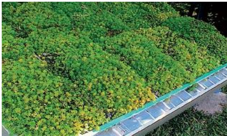
Figura 11: Telhado verde modular. Fonte: Arco (2009)
