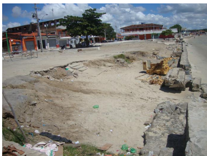
Foto 7: Praça principal, com destaque para a destruição causada pelo avanço do mar
