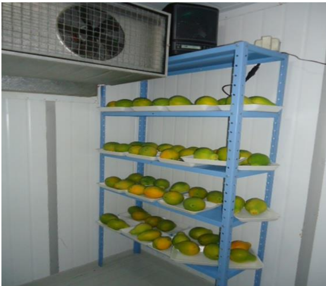
Figura 4. Equipamento Fotocatálise Heterogênea (FH) instalado em câmara fria 12°C.
