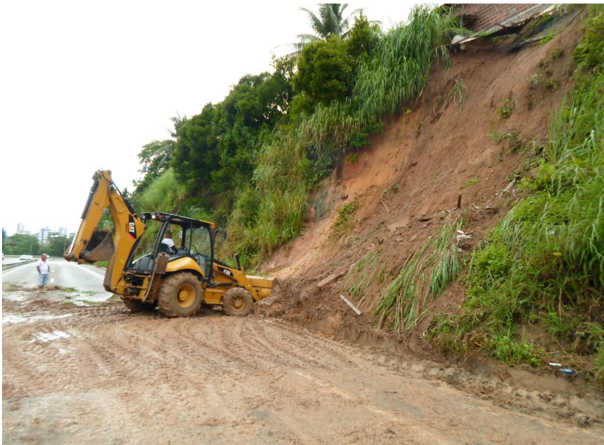
Figura 29 - Deslizamento de terra em vertente de corte de estrada na BR 230, bairro do Castelo Branco. Fonte: Acervo fotográfico da Coordenadoria Municipal de Proteção e Defesa Civil / COMPDEC – JP (2014).
