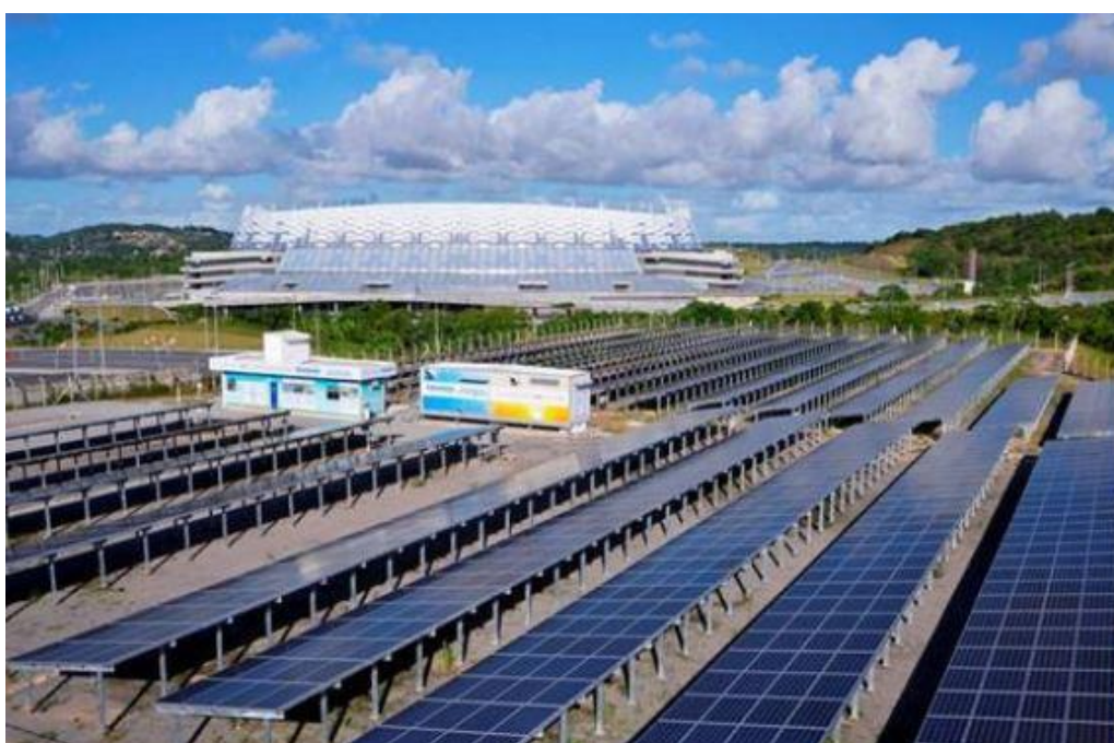
Figura 52 - Painéis Solares do Sistema Central
