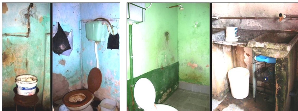
Figuras 50 e 51: Imóveis ilustrando a precariedade das instalações elétrica e hidráulica encontrada em grande parte das edificações visitadas.
