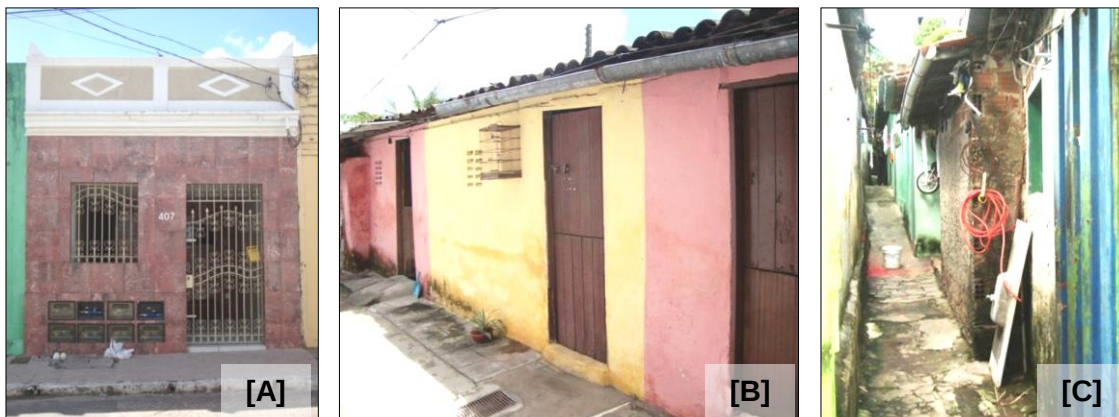
Figuras 41, 42 e 43: Imóveis representando respectivamente os níveis de conservação da estrutura externa: bom [A], regular [B] e deteriorado [C].
