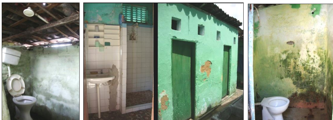
Figuras 52, 53 e 54: Banheiros coletivos de cortiços.
