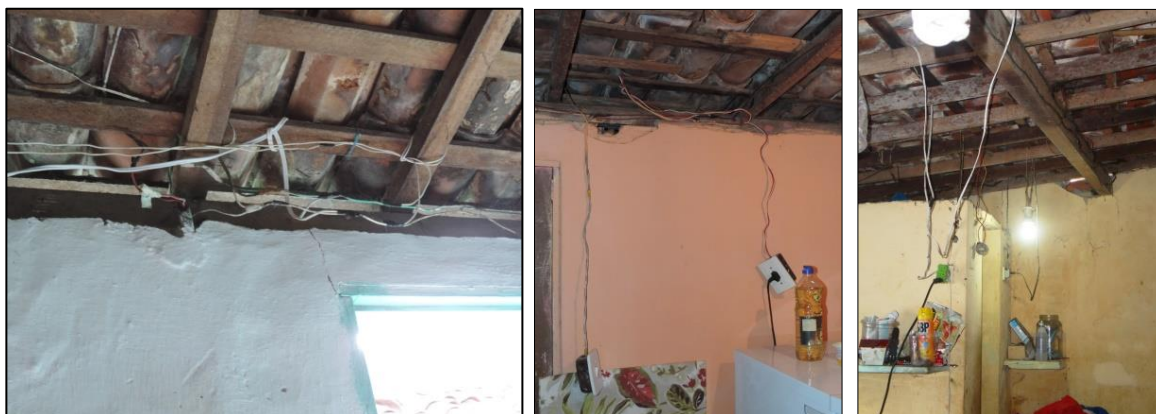
Figuras 75, 76 e 77: Exemplares das condições das instalações elétricas nas HCPAs estudadas.
