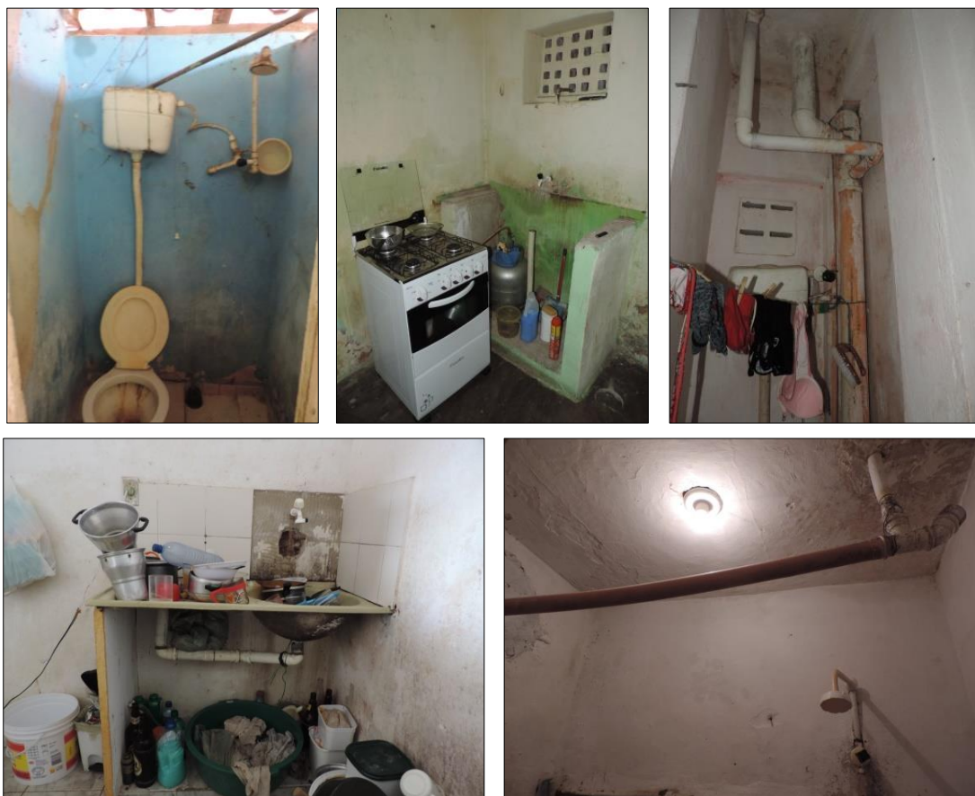
Figuras 78 a 82: Exemplares da precariedade das instalações hidráulicas nas HCPAs estudadas.
