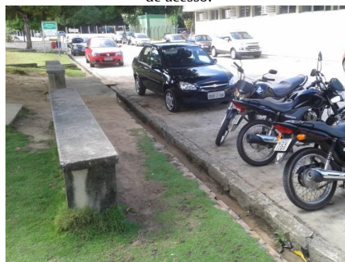
Figura 17: Fotografia dos bancos e ausência de calçada de acesso.
