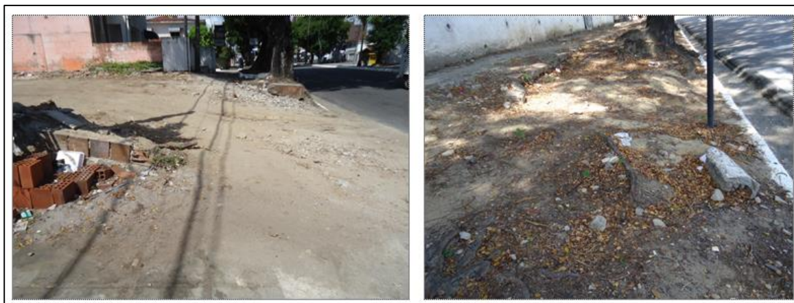
Figura 18. Exemplos de calçadas não pavimentadas.
