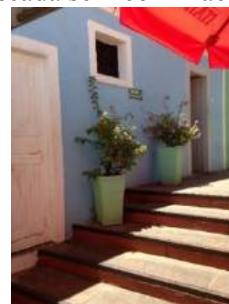
Figura 45. Escada sem corrimão do lado direito
