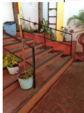
Figura 47. Detalhe de um guarda-sol instalado de forma inadequada
