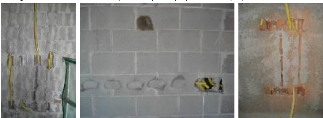
Figura 68: Quebra na alvenaria por alteração de projeto e/ou despreparo da mão de obra.
