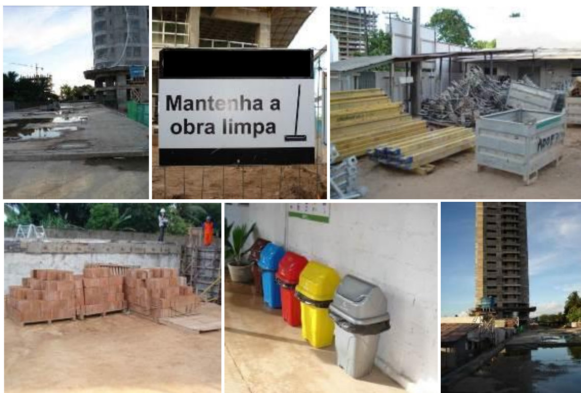
Figura 69: Sinais do nível de organização da obra do projeto nº 212 (01/2008).
