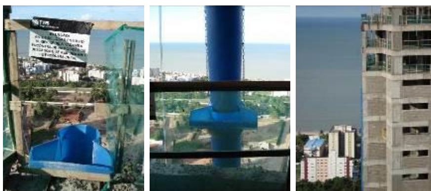
Figura 71: Duto para transporte vertical de RCC Classe A.
