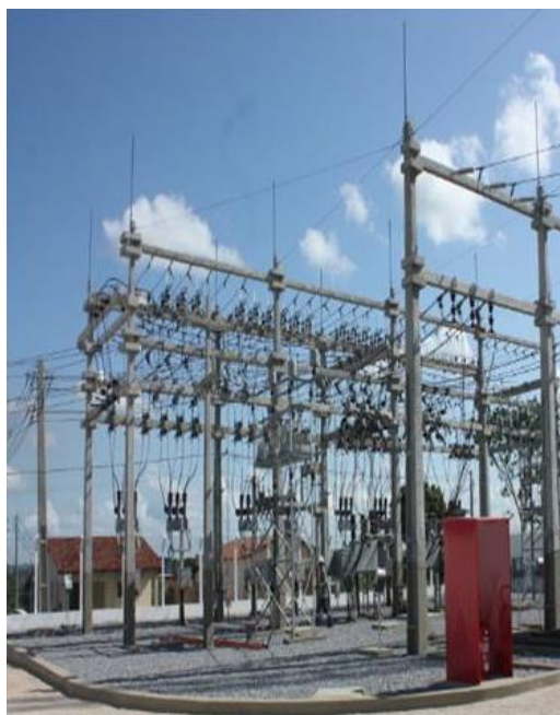
Figura 2.5 - Subestação de Rio Tinto II (Energisa/PB), do tipo abaixadora 69/13,8 kV.
