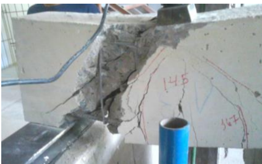
Figura 62 - Ruptura do estribo e desprendimento superficial do concreto.
