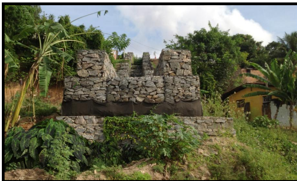
Foto 17 – Dissipador de água na Rua Oswaldo Lemos. (Créditos: Acervo do GREM, 12/11/2012).
