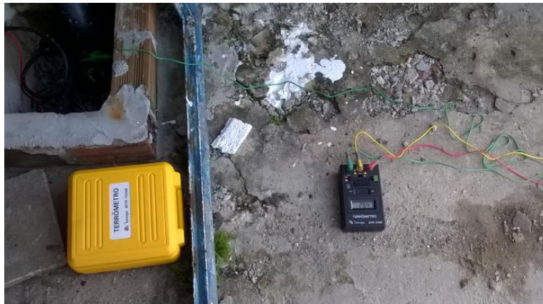
Figura 4.14 – Leitura da resistência de terra
