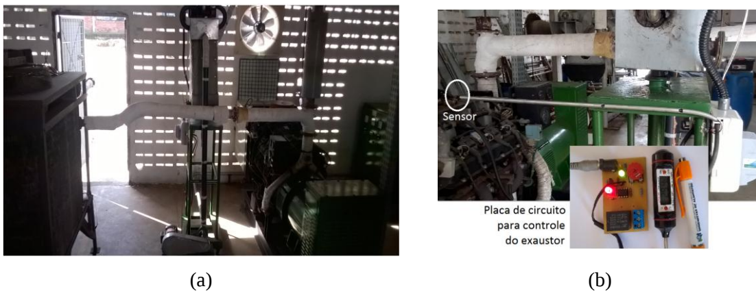
Figura 4.1 – Instalações do GMG. Detalhe para o circuito de controle no acionamento do exaustor.
