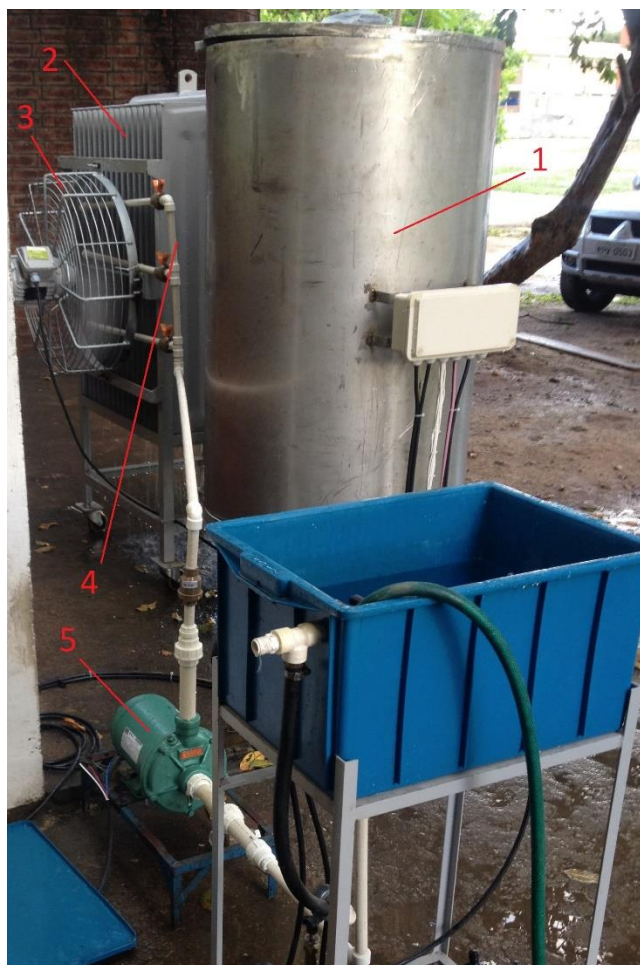
Figura 3.1: Composição geral da bancada experimental. 1- Reservatório de óleo que simula o núcleo do transformador; 2- Radiador de um transformador de 69 kV; 3- ventilador; 4- Sistema de aspersão de água; 5- bomba centrífuga.
