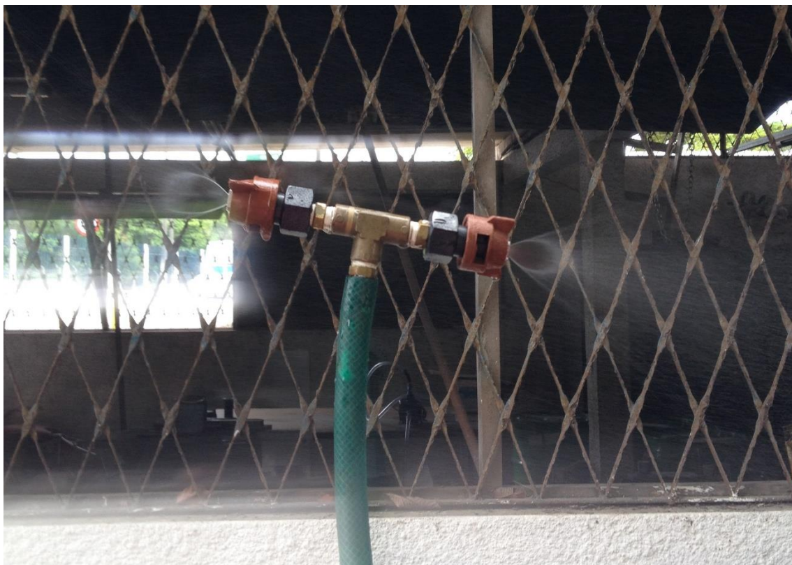
Figura 3.16: Bico selecionado para compor o sistema final de resfriamento evaporativo do transformador de força.
