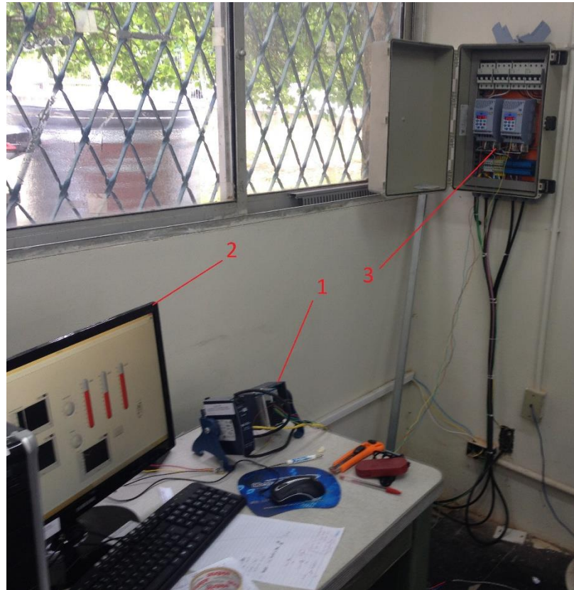
Figura 3.2: Sistema de monitoramento e aquisição de dados. 1- Data logger; 2- Monitoramento do sistema através do LabView; 3- Inversores de frequência do ventilador e da bomba.
