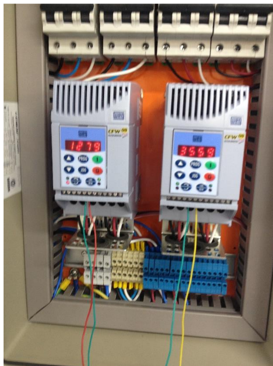
Figura 3.8: Inversores de frequência do ventilador e bomba.
