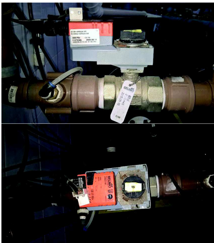
Figura 4.6 - Válvula Redutora de Pressão
