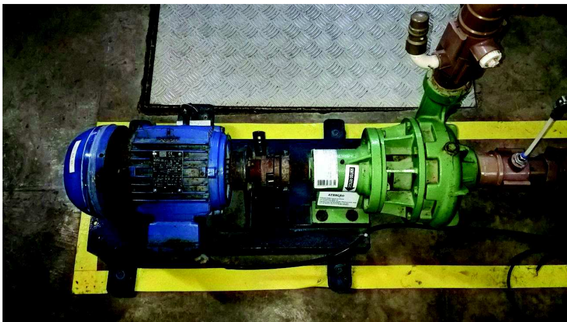
Figura 4.2 - Conjunto Motor Bomba
