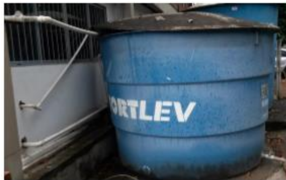
Figura 5.6 - Reservatório de água.
